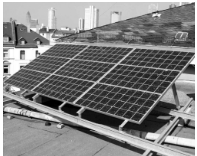
Die Nutzung erneuerbarer Energien – hier eine Photovoltaik-anlage – ist eine wirksame Maßnahme für den Klimaschutz.
